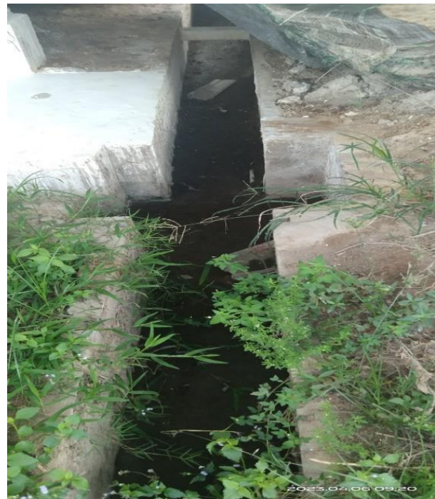
Rãnh thoát nước thải
