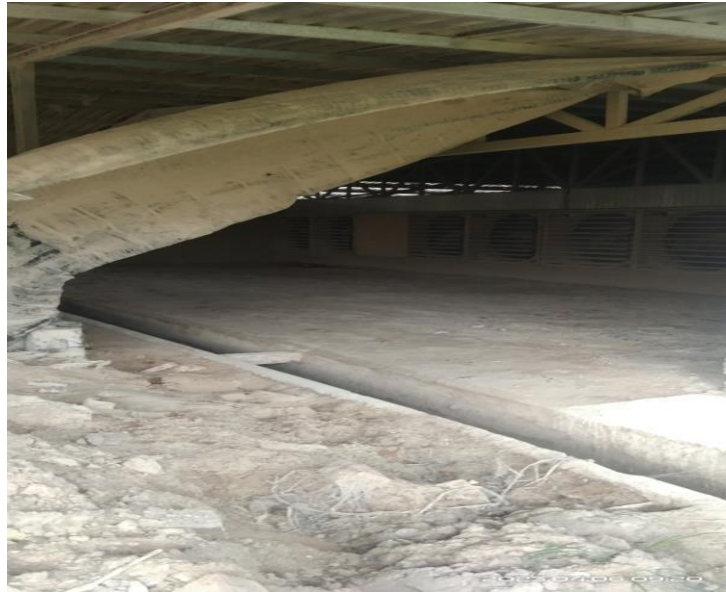
Hình 3. 4. Hệ thống quạt thông gió
